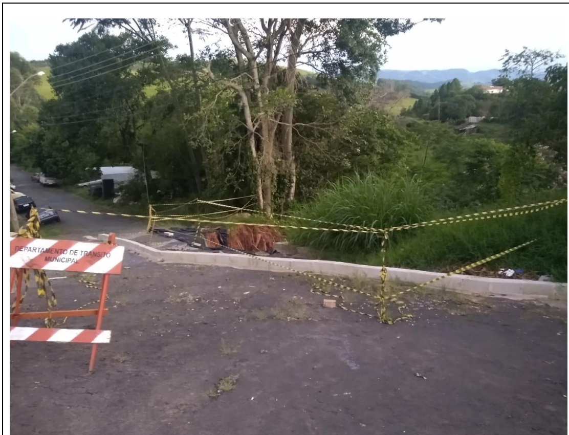
Figura 4 – Rua Francisco Pereira Mourão, proteção de talude com parede para desviar águas pluviais.
