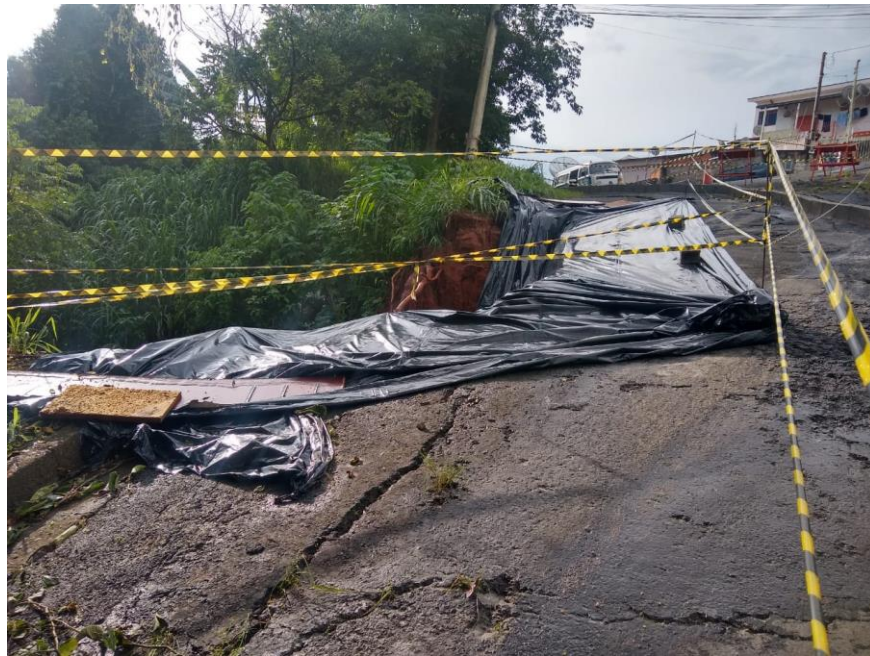
Figura 2 – Rua Francisco Pereira Mourão, proteção de talude com lona plástica.
