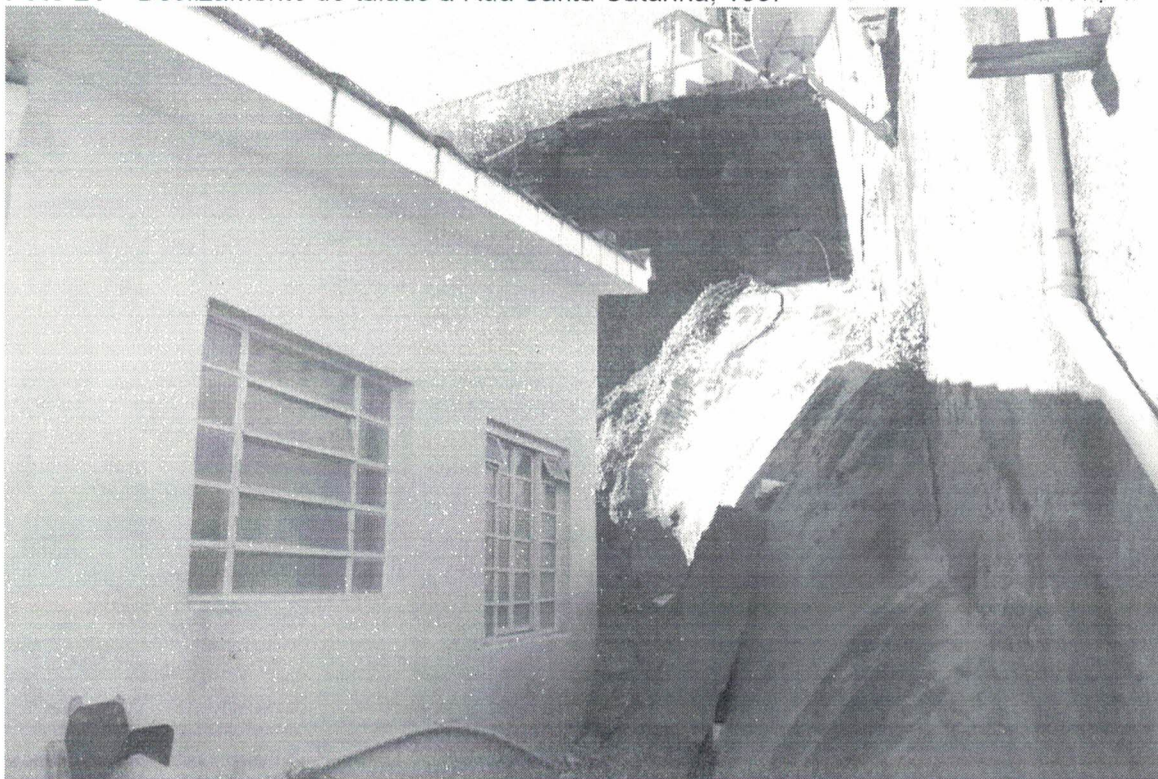
Foto 21 – Deslizamento do talude à Rua Santa Catarina, 133.
