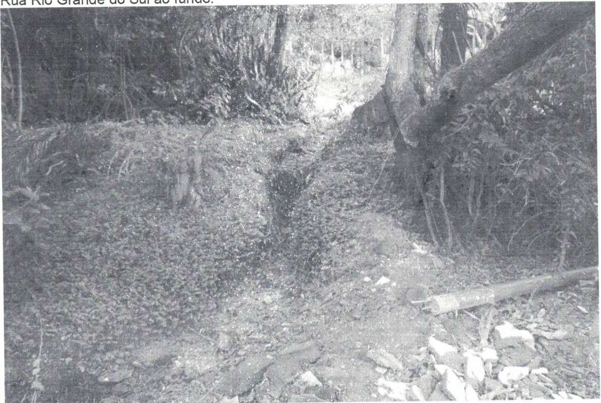
Foto 34 – Local por onde desce parte das águas pluviais quando ocorrem chuvas intensas. Rua Rio Grande do Sul ao fundo.
